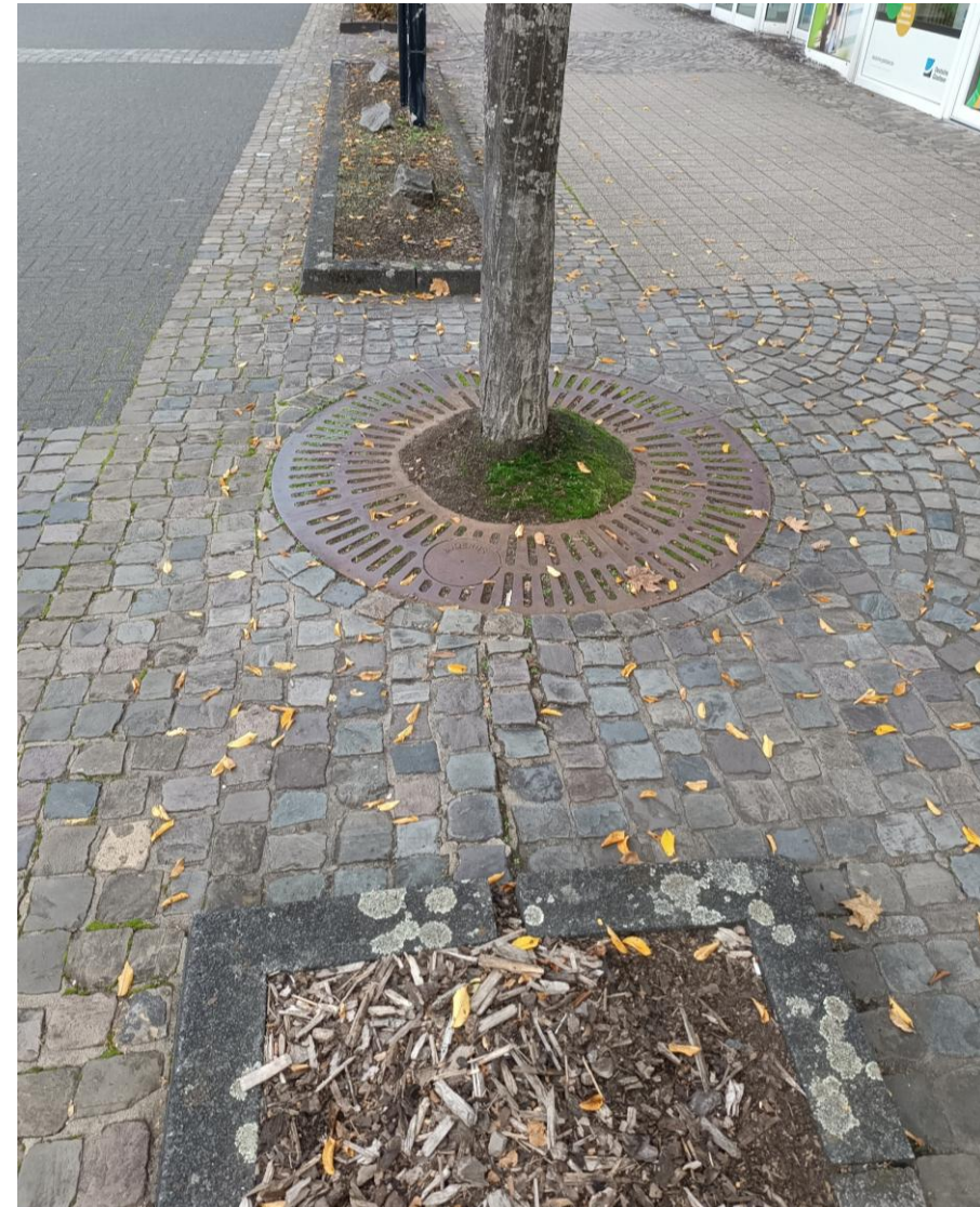
Abb. mangelhafte Pflanzbereiche (Quelle: eigene Aufnahme, Kirchen (Sieg) 10/2024)
