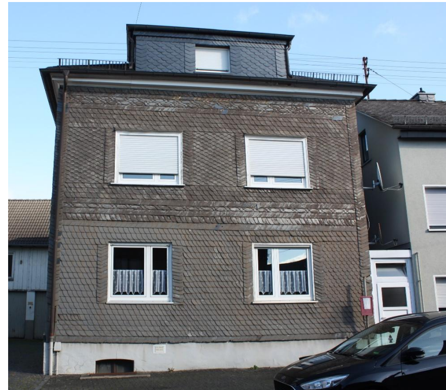
Abb. Gebäude in der Hauptstraße mit mittlerem Sanierungsbedarf (Quelle: eigene Aufnahme, Kirchen (Sieg) 10/2024)
