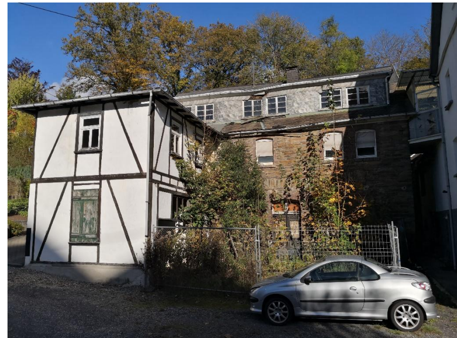
Abb. Gebäude in der Klotzbachstraße mit hohem Sanierungsbedarf und sehr schweren Mängeln (Quelle: eigene Aufnahme, Kirchen (Sieg) 10/2024)
